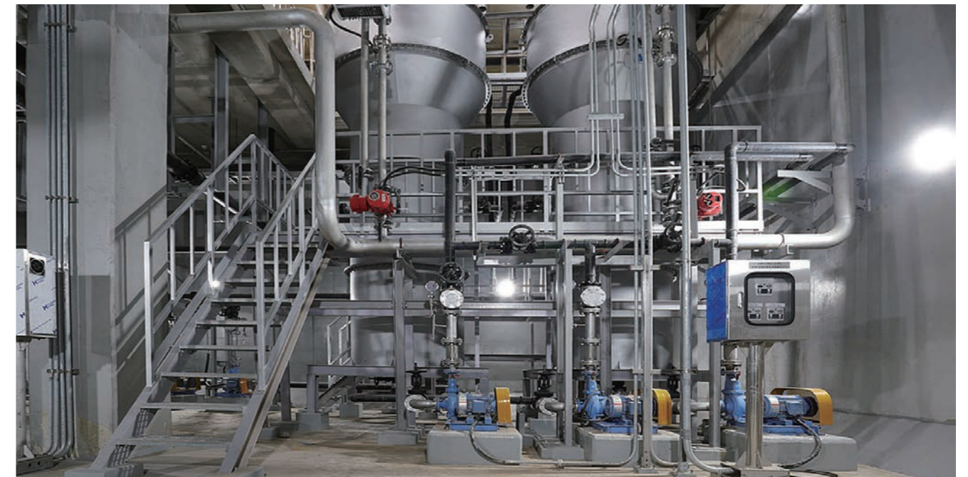
부산 녹산 하수처리장 Sidestream AMX _ 국내 최초 상용화 (780m³/d)
